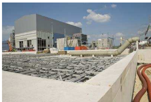
Vue générale emplacement des tours humides premier plan et halle des machines Avril 2010 / PATRICK MARTIN PHOTOGRAPHE
